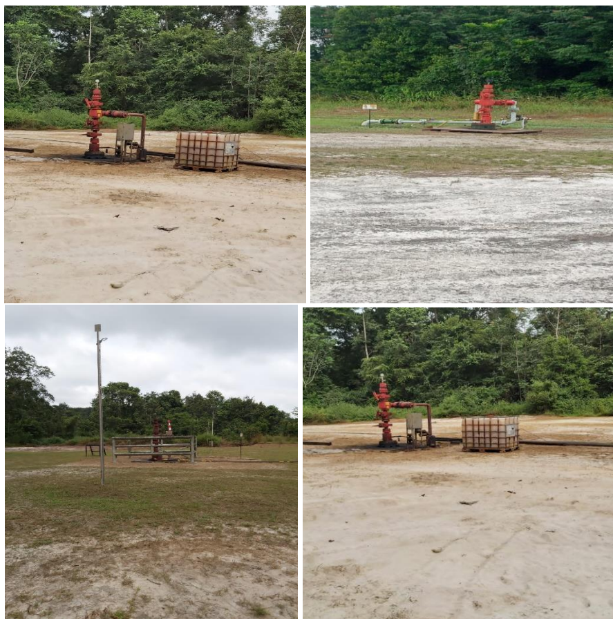
Photo 1: Vue de quelques installations à OBA.
